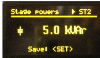
5. Ustawienie mocy kondensatora 2st. na 5kVar aż do wypełnienia konfiguracji baterii.
