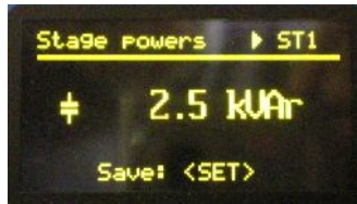
4. Ustawienie mocy kondensatora 1st. na 2,5kVar.
